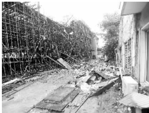
脚手架垮塌现场
