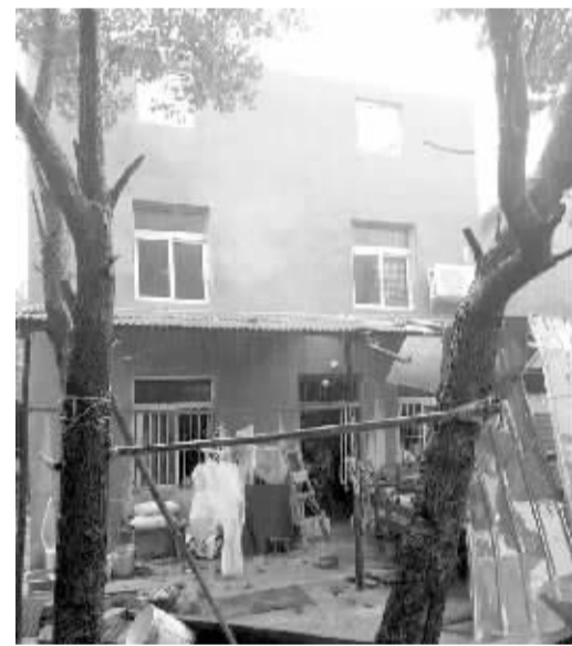
被狂风掀掉屋顶的楼房
