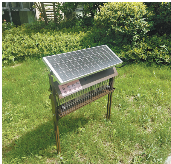
小区内安装好的灭蚊灯。
