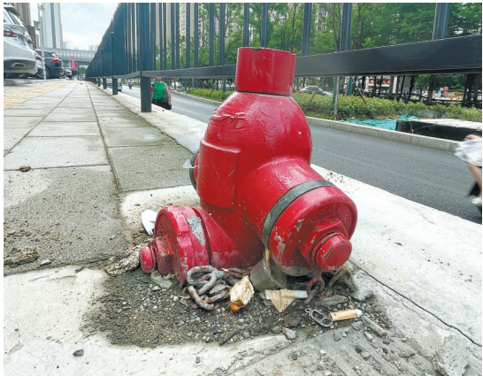
消火栓80%被埋在地里。
