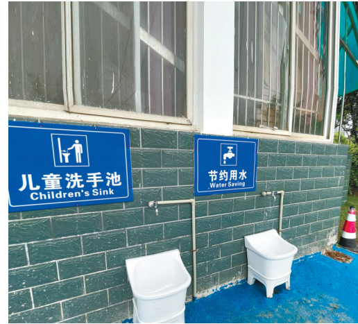
杨泗港大桥江滩公园的沙滩游乐场旁新安装的洗手池。 记者杨荣峰 摄
