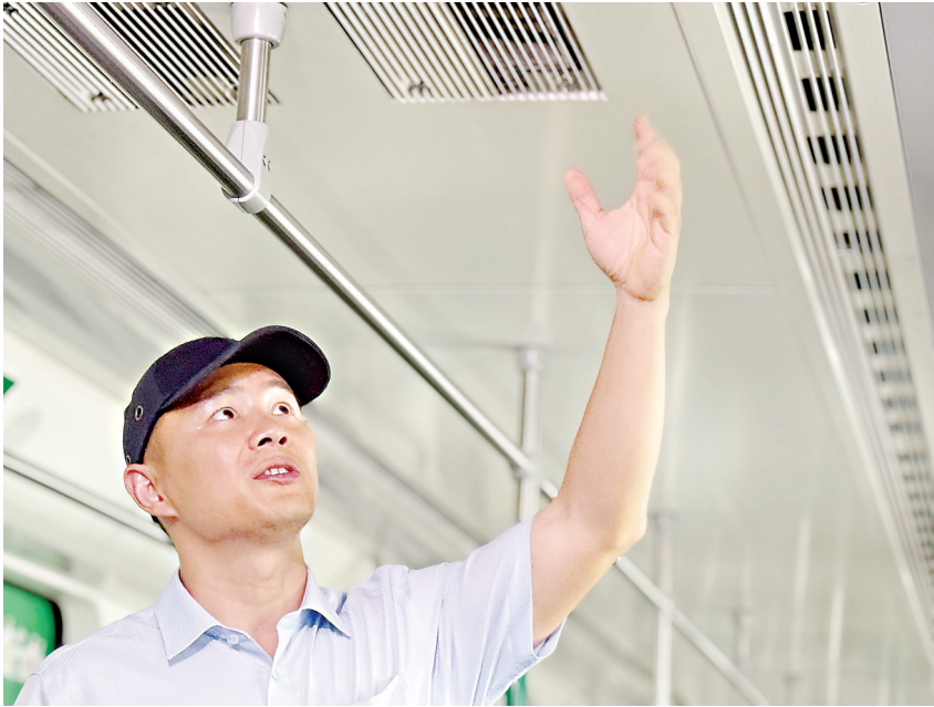
陈博介绍地铁列车空调检修过程。
