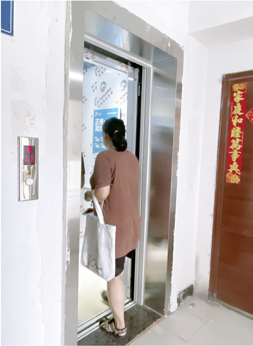
B栋4单元的新电梯正在试运行。
