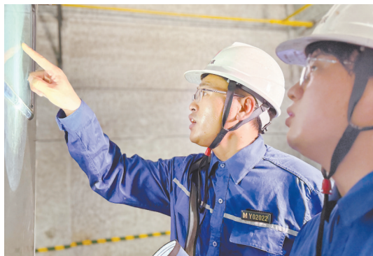
董锐（左）和同事肖欣宇巡视武汉地铁徐家棚主变电所核心区域控制室。
