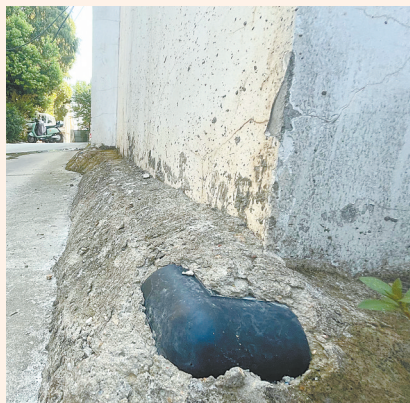
水管很多地方裸露在外。
