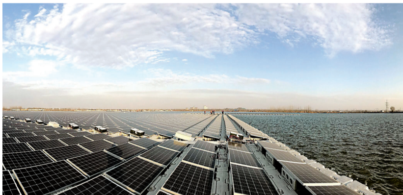
刘海波团队研发的新型水上浮体运用于安徽两淮采沉陷区淮南水面光伏项目。
