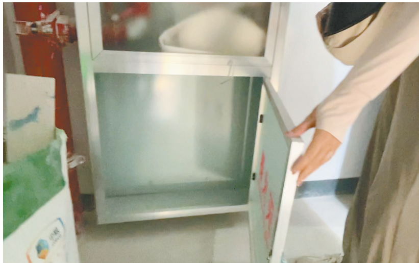
记者随机查验楼道间的消防柜，柜内未配灭火器。
