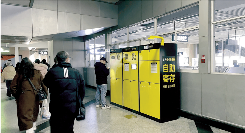
1号线大智路站,设置3个自助行李储物柜,工作人员正在进行设备调试。 记者杨荣峰 摄
