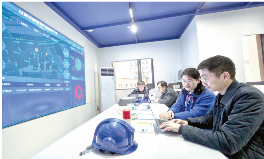
大屏前,工作人员对燃气用户24小时用气安全实时监控管理。 记者何晓刚 摄
