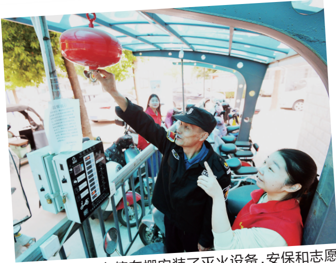
小区电动车停车棚安装了灭火设备,安保和志愿者不定期检查设备是否完好。
