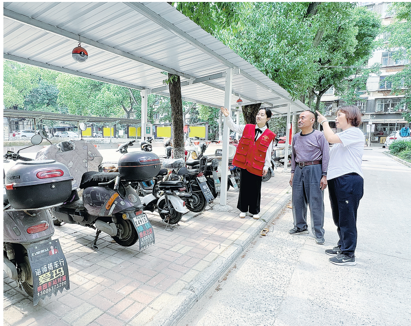
新建的电动车棚安装了消防设施。
