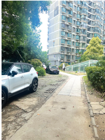
小区改造前道路破损。
