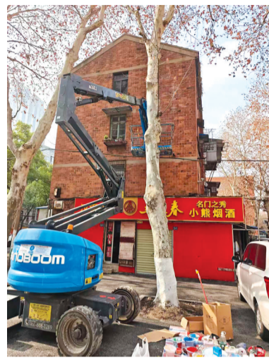
虹蔚社区47街小区墙面老旧。(改造前)
