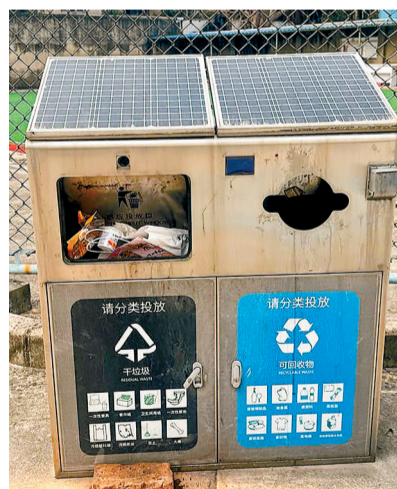
智能垃圾箱电子功能处于失灵或损坏状态。
