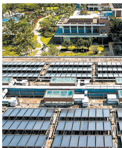
东屿岛大酒店屋顶的光伏设备。
