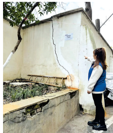
△维修前,开裂的墙体。
