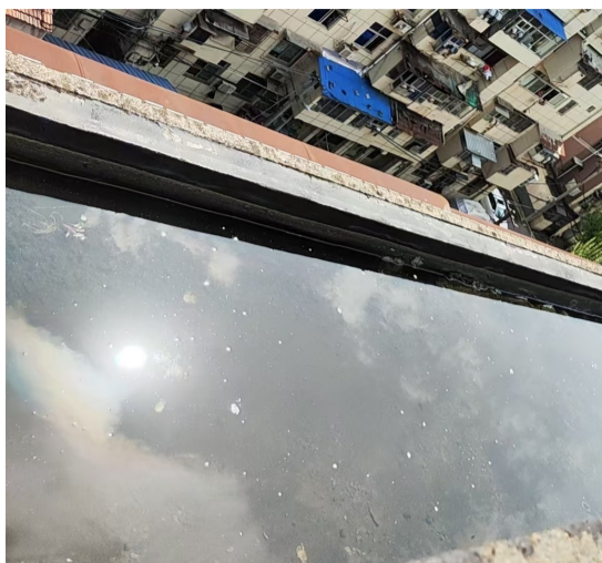
楼顶排水口被堵积水。
