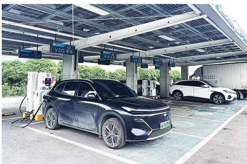
位于中法生态城的中建科工充美“光储充放”一体化超级充电站。
