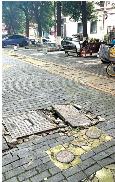
塌陷地面地砖修缮前。
