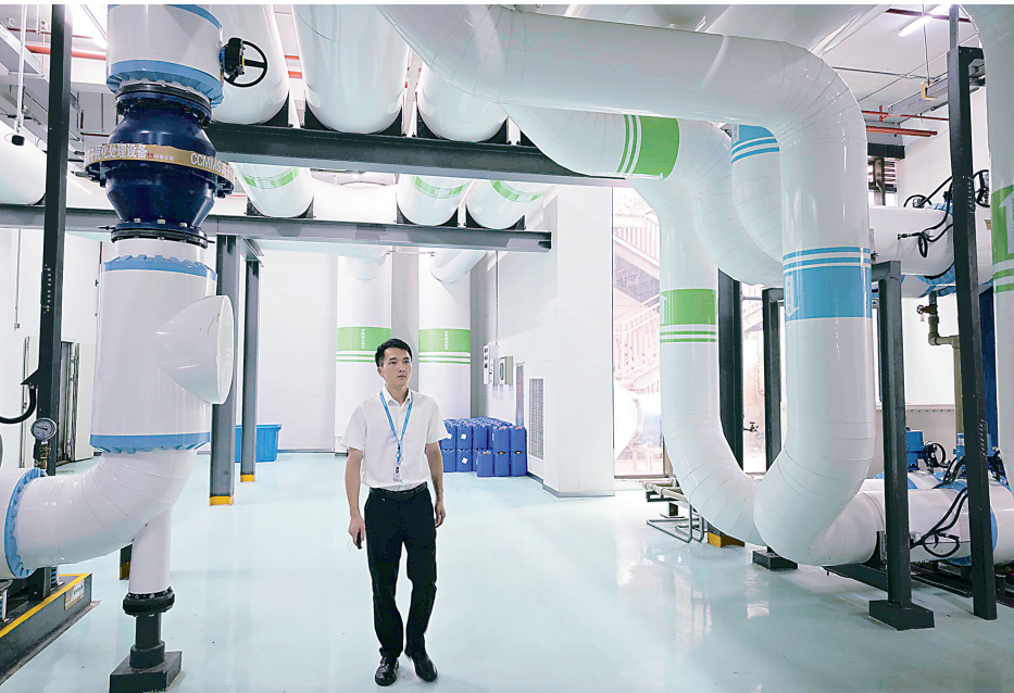
中建科技产业园综合能源站内,粗大水管构成庞大处理系统。
