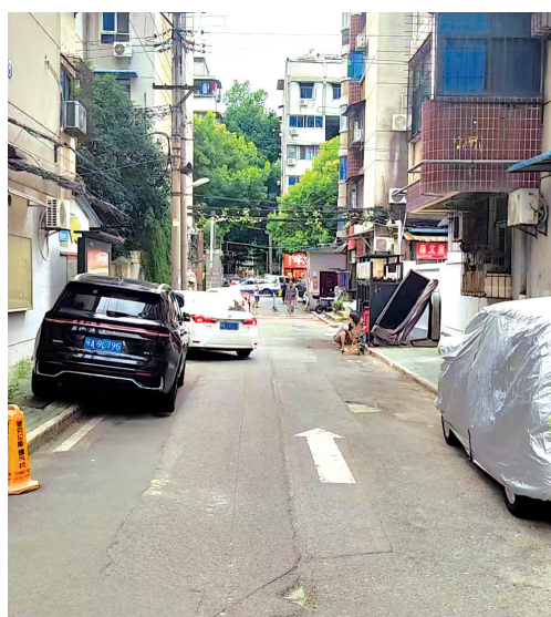
改造前,道路破损,墙面斑驳。
